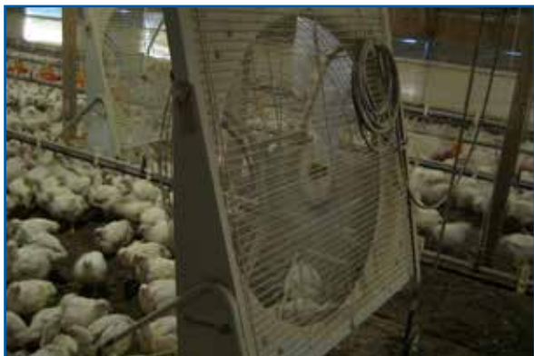
Figure 6.2 : ventilateur de circulation dans un bâtiment à ventilation naturelle.
