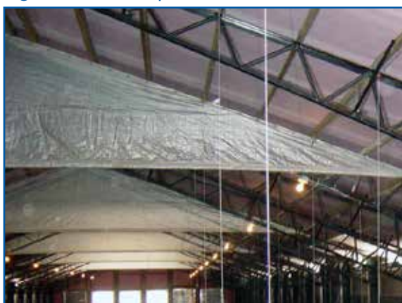
Figure 6.14 : exemple d'installation de déflecteurs/écrans suspendus dans un bâtiment à ventilation en tunnel.
