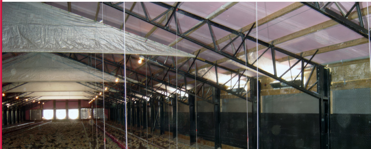
Figura 6.19 Ejemplo de colocación de deflectores en un galpón con ventilación por túnel.
