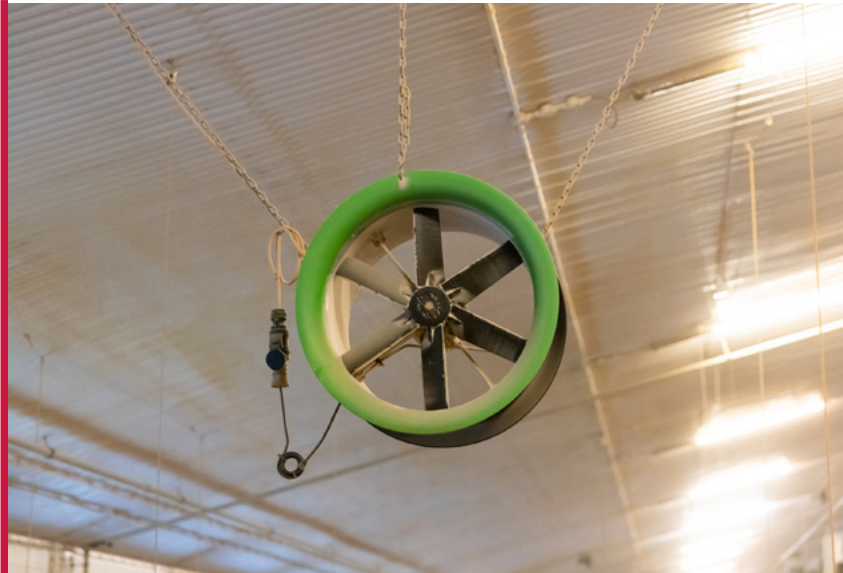
Figura 6.6 Ventiladores de circulación en un galpón abierto/con ventilación natural.
